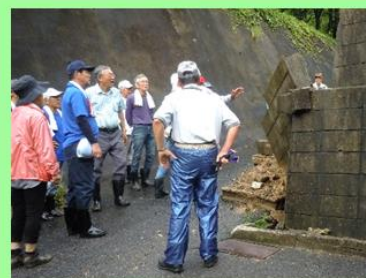
【水を含んだ土砂でブロック塀も倒壊しました】
